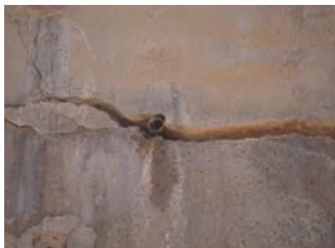
شکل ۹. زهکش تخریب و مسدود شده در جناح راست سد مسجد سلیمان
