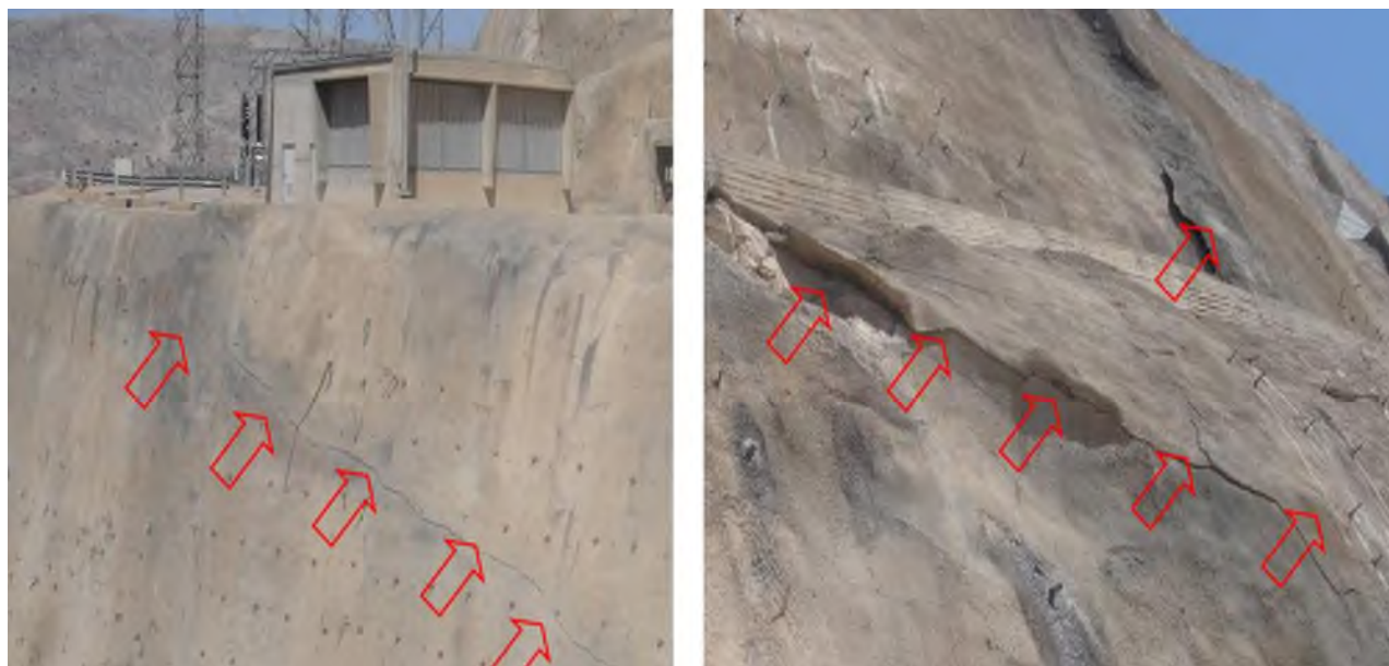
شکل ۱. ترک‌های ایجاد شده روی سطح شاتکریت به همراه ریزش بخش‌هایی از برم‌های مشرف به ترانشه
